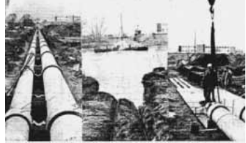
Gleich fünf Rohrstränge werden vor 50 Jahren durch den Main gezogen. Foto: Hans Lembach
